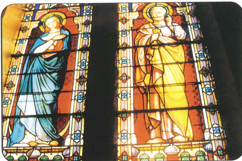
Vitraux avant restauration
